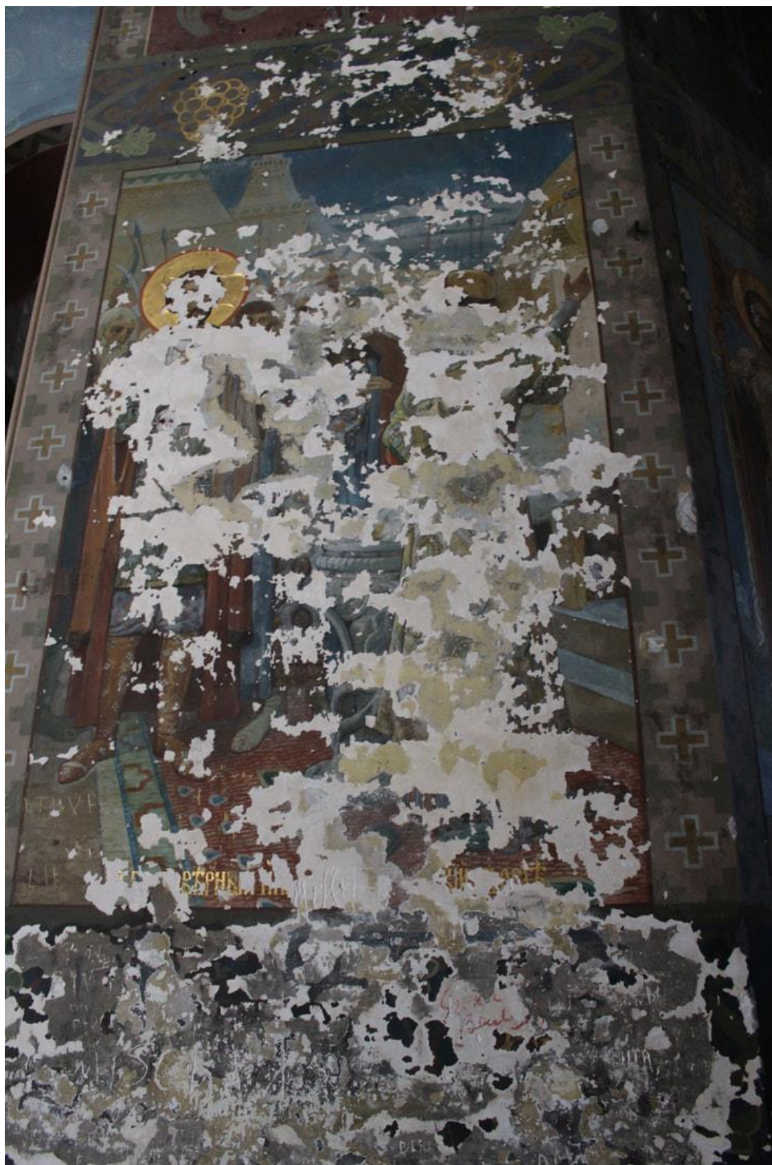
Niestety niektóre malowidła wolają o renowację...
